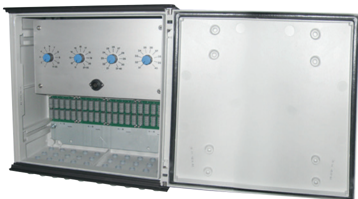
Fig.: Vista interior EAUK K con 40 puntos de medida
